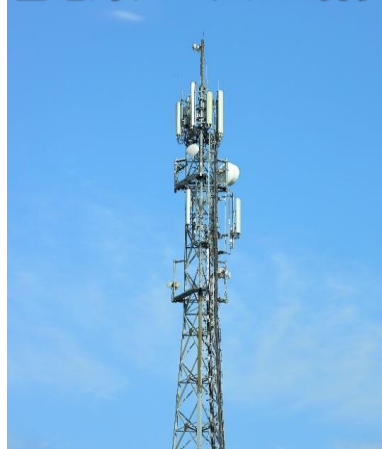
基地局アンテナの現状
