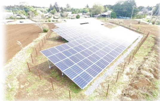
かすみがうら市加茂低圧4区画発電所①
