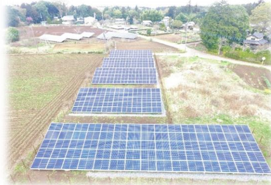
かすみがうら市加茂低圧4区画発電所②
