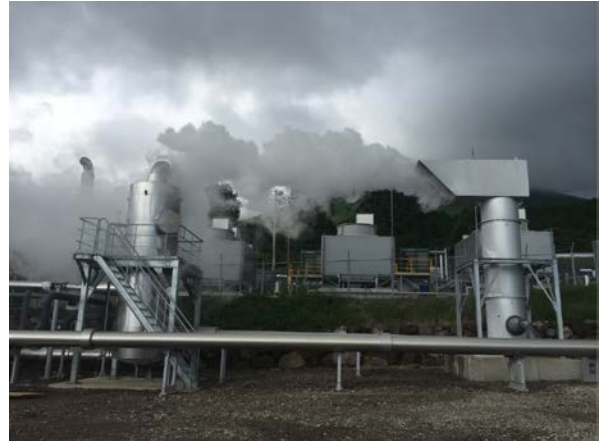
別府地熱発電所近隣の地熱発電所設備
