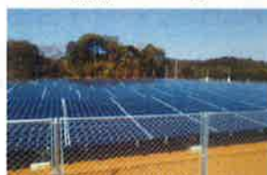
③長崎県波佐見町発電所(400Kw)
